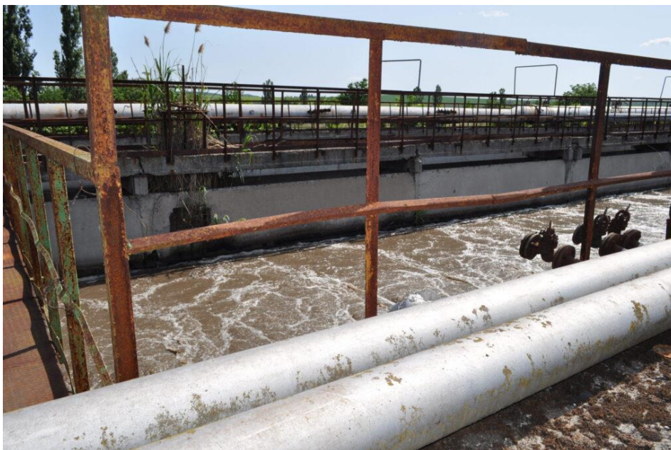
Рис. 2. Каналізаційні насосні станції
