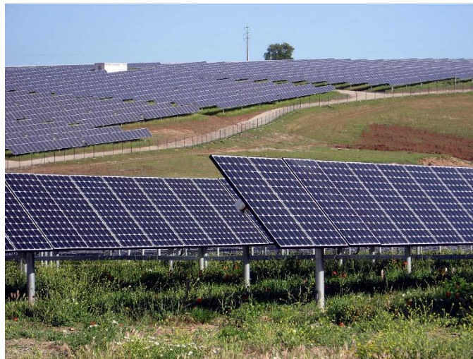
Рис. 1 – Загальний вигляд сонячної електростанції
